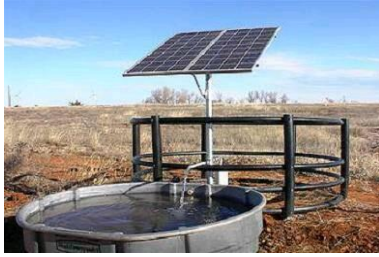
a. Hệ thống bơm
